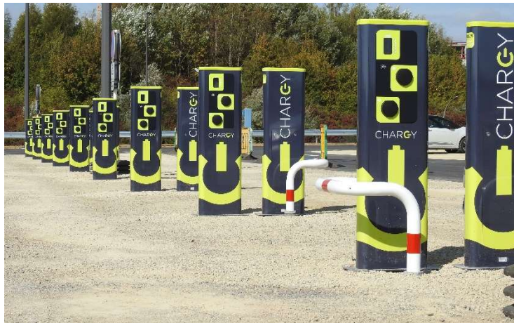
27 bornes Chargy sur l'extension du P&R Howald Sud, septembre 2018
