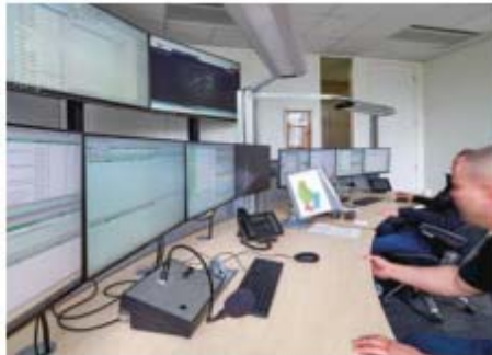
3 Poste de commande (Verkeiersverband)
